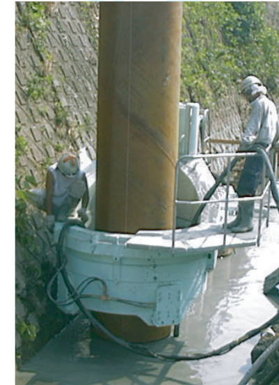
土佐機械工業製 鋼管矢板圧入機 STILL WORKER WP150P 〔神奈川県藤沢市にて初施工 2001年(平成13年)7月〕
