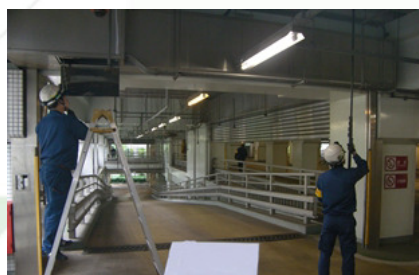
防火シャッター動作試験
