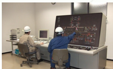
変電設備保守管理
