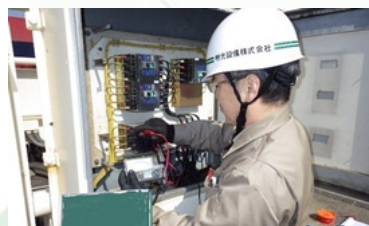
日常巡視保守点検
