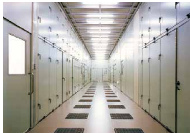
クリーンルーム
