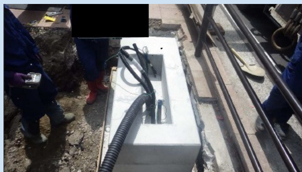
現場での設置状況
