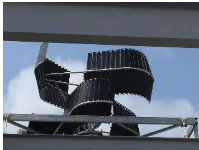
沖縄ビル屋上設置v
