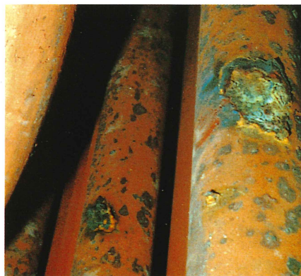
溶存酸素による腐食事例
