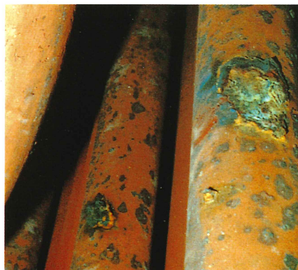
溶存酸素による腐食事例
