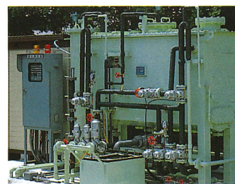
排水再生処理装置
