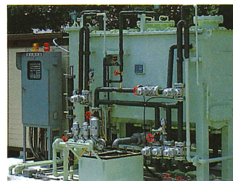
排水再生処理装置
